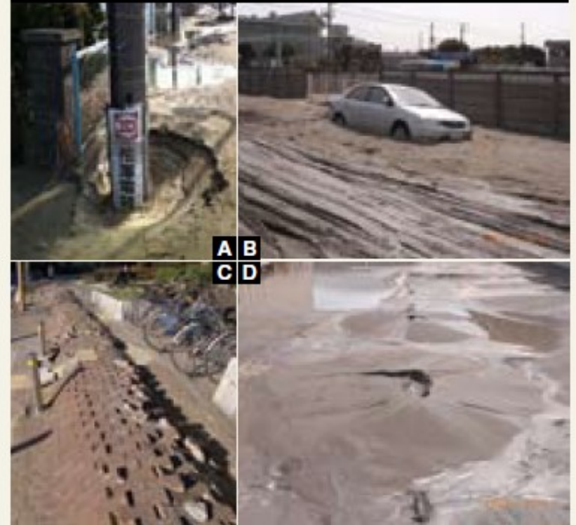
A 電柱が約 1m 沈下 B 噴砂に埋もれた車 C 盛り上げる歩道のブロック D いくつもの噴砂丘が残る
