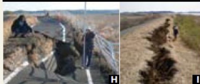
H、I 北印旛沼ではサイクリング道の一部で、亀裂や崩落、沈下といったことが起きた。
